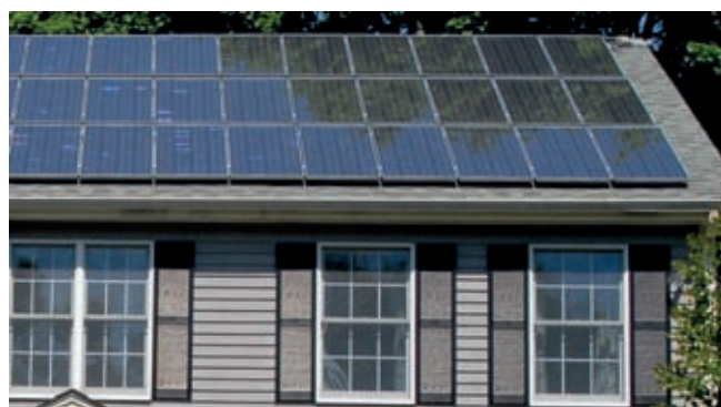
Rys. 1. Kolektor słoneczny na dachu budynku
