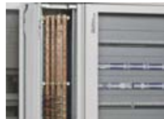
Rys. 3. Szyny zbiorcze pionowe w wydzielonym przedziale rozdzielnic
