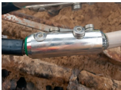
Fot. 3. Przykład nieprawidłowo zerwanych śrub w złączce.
