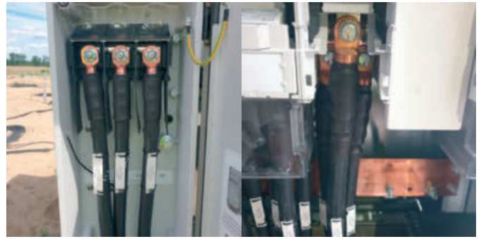
Rys. 9 Przykład zastosowania końcówek KMA na farmie fotowoltaicznej.
